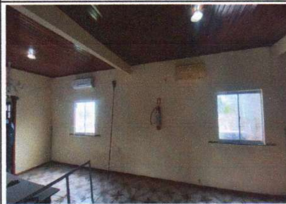
Foto 4: Vista do salão com 04 centrais de ar.
