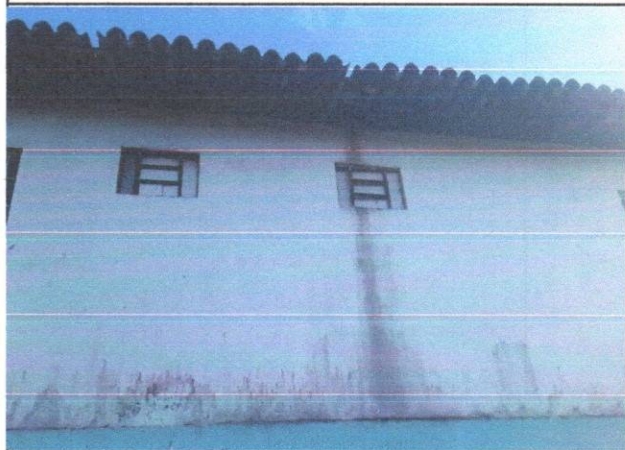
Foto 3: Balancim com vidros quebrados
